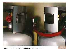
●シャットアウトシステム。 (LPボンベ室)
