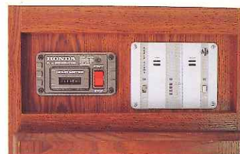
ジェネレータスイッチ & LP/COアラームモニター
